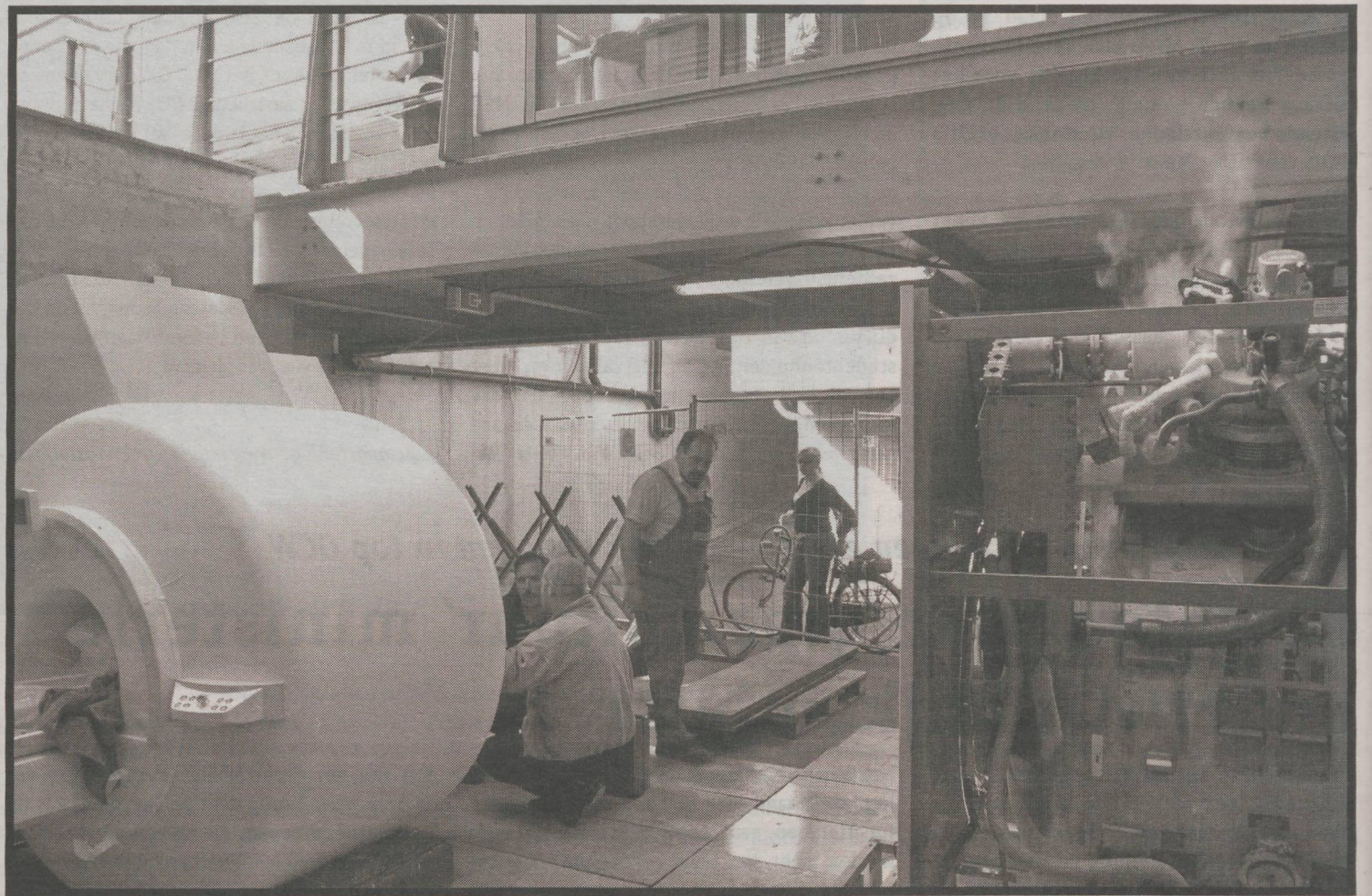
De installatie van 's lands eerste hoofds scanner in de kelder van de UNS 40 Foto: Philip Driessen
