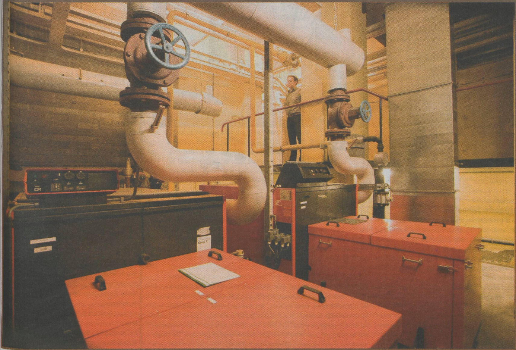
Het ketelhuis van het jezuïetenklooster aan de Tongersestraat. Onder andere dit pand loopt voorop in het nieuwe 21-gradenbeleid: op de werkkamers niet hoger stoken dan 21 graden. Maar een rolstoelgebruiker die recht heeft op onbelemmerde toegang bleek roet in het eten te gooien; de tochtdeuren moesten open blijven. Zie pagina 8-9 Foto: Philip Driessen
